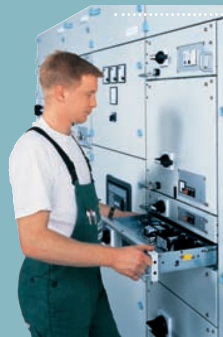
быстрая замена выкатного модуля
